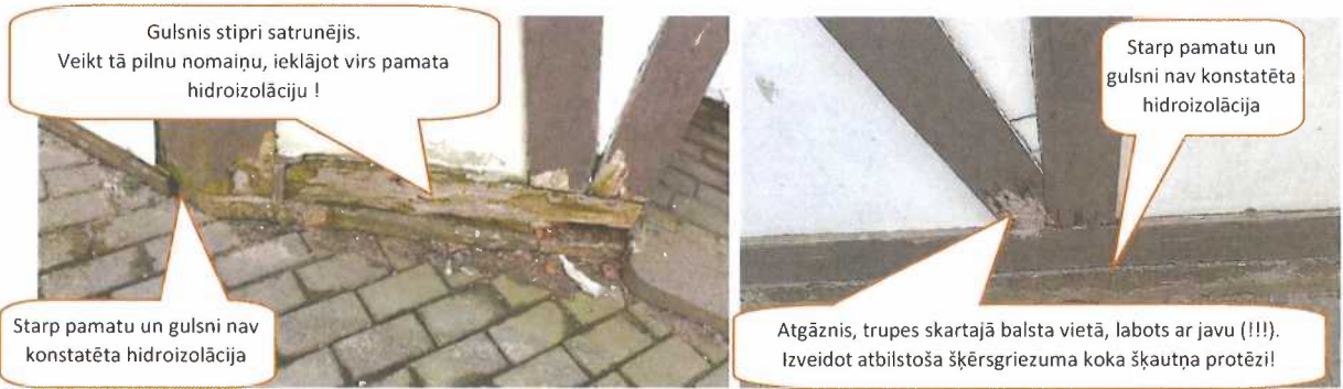
9., 10.attēls. Balsta vietā bojāta koka karkasa konstrukcija – trupes bojājumi ziemeļu un rietumu pusē.
